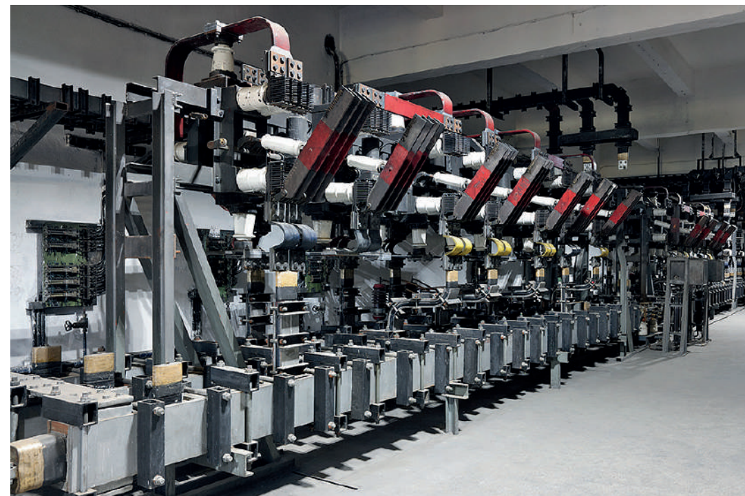
Circuite electrice în laboratorul de mare putere.
