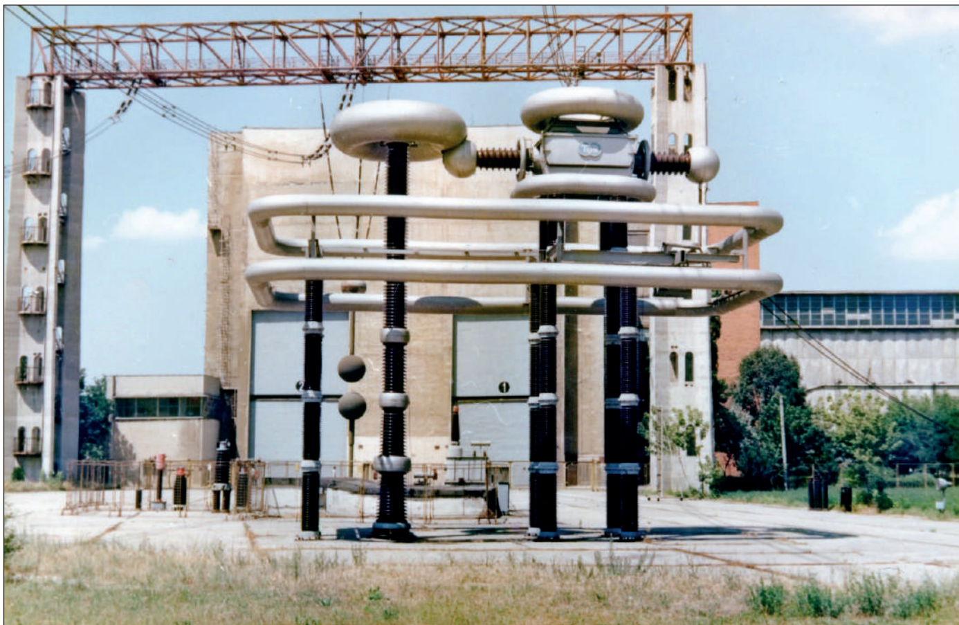
Vedere generală din câmpul exterior al laboratorului de înaltă tensiune.
