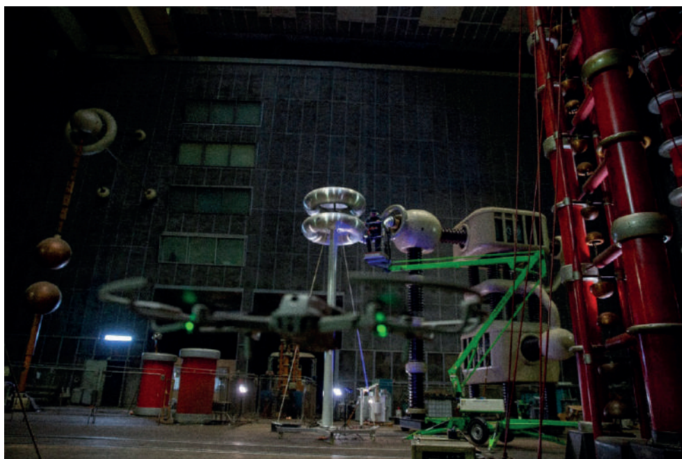
Vedere din interiorul laboratorului de înaltă tensiune.
