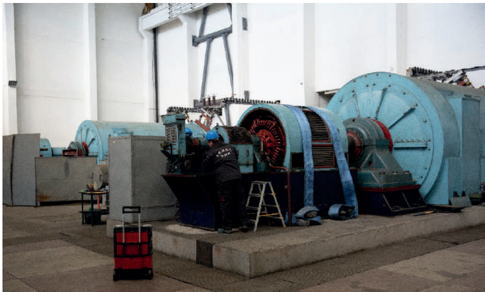
Grup de generatoare de mare putere în sala mașini din cadrul laboratorului LMP.
