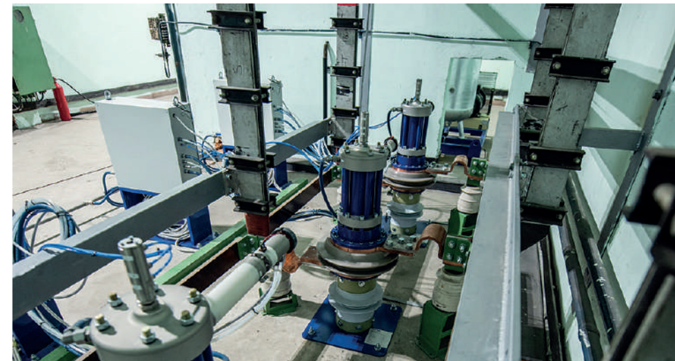
Contactor din circuitul de comandă la mare putere.
